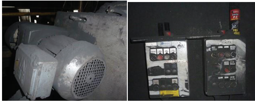
Fotoęraf 7 – Elektrikli Ekipmanlar Üzeri Aşırı Kömür Tozu Birikimi Örnekleri (İkincil Patlama Risklerini Tetikleyecek Durumlar)
