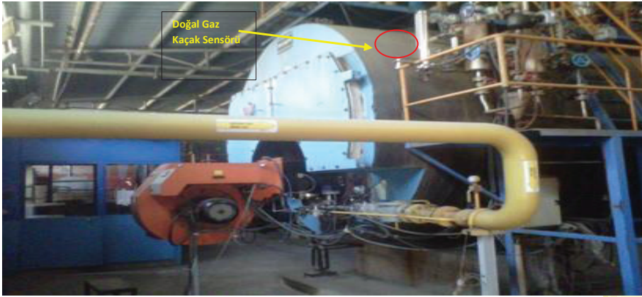
Fotoğraf 16 - Doğal Gaz Kazanı Besleme ve Akış Kontrol Vanaları (Bakım Platformu Üzeri Doğal Gaz Kaçak Sensörü Mevcut - Nokta Ölçümü)
